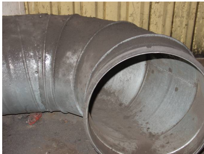
Solche Rohrsysteme sollten der Vergangenheit angehören!
